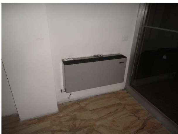
Ventilconvettore più vecchio
