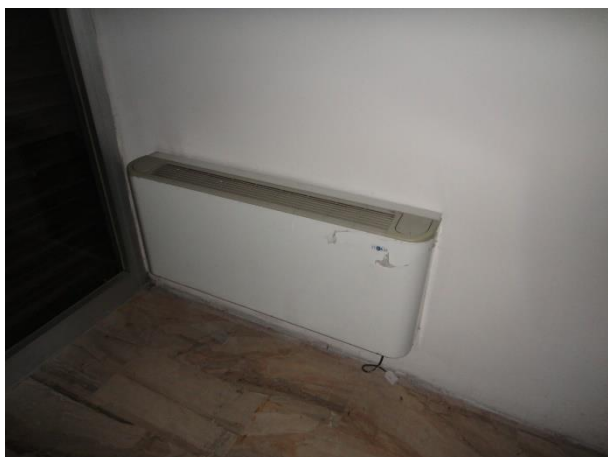
Ventilconvettore più recente
