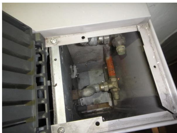
Dettaglio valvole di intercettazione
