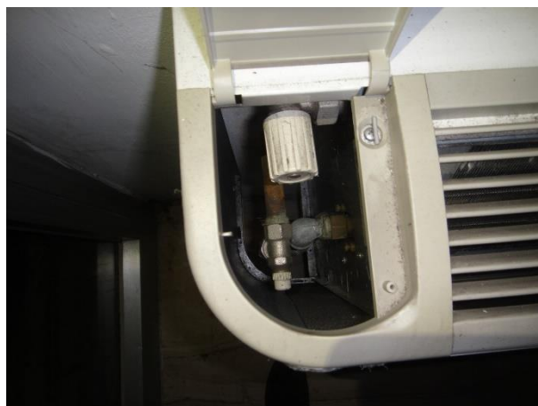
Dettaglio valvole di intercettazione
