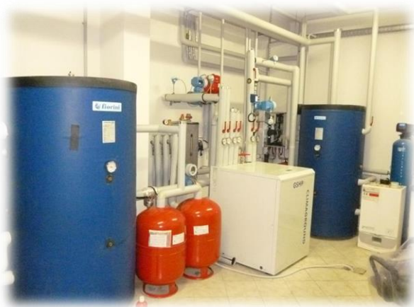
FIGURA 2 - INQUADRAMENTO CENTRALE TERMICA
