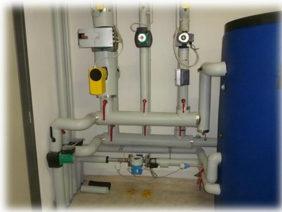
FIGURA 6 – GRUPPO DI POMPAGGIO
