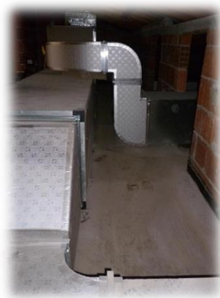
FIGURA 11 – UNITÀ TRATTAMENTO ARIA
