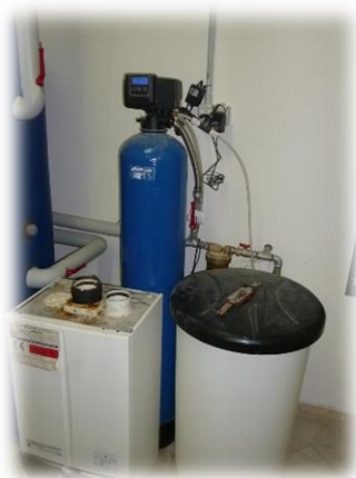
FIGURA 10 – GRUPPO DI TRATTAMENTO ACQUA
